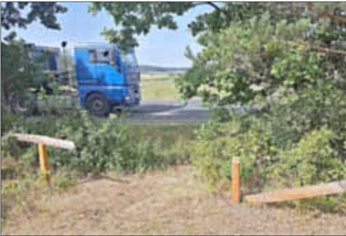
Schon wieder wurde die der Sicherheit dienenden Abplankung an der B289/Abzweigung Fischbach/Frickendorf zerstört. Foto: Helmut Will
